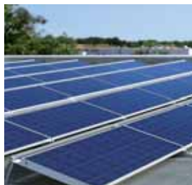
Fotovoltaické zařízení s Vitovolt 300.
